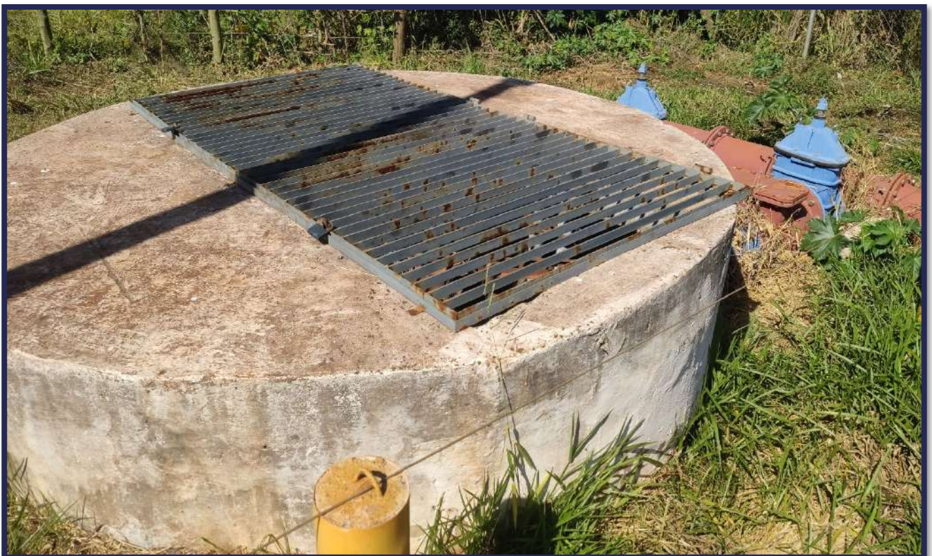
Figura 4-18 - Vista atual das instalaes da ETE Vacari.
