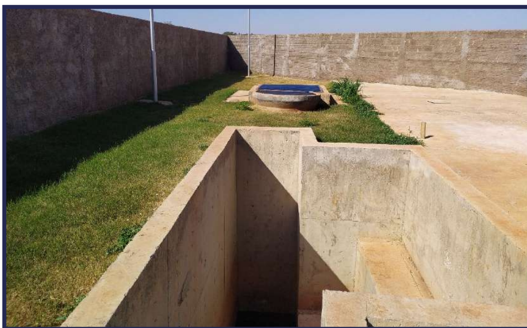
Figura 4-15 - Vista atual das instalações da EEE CDUH.
