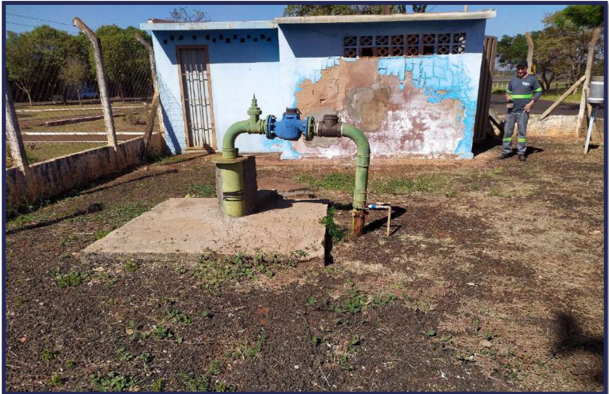
Figura 3-14 - Vista atual das instalaes do Poo 08.
