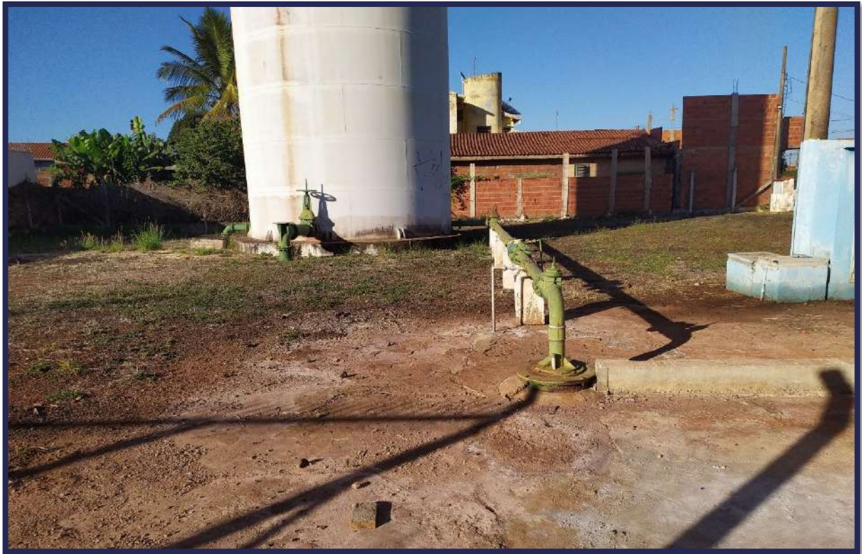
Figura 3-23 - Vista atual das instalaes do Poo 06.
