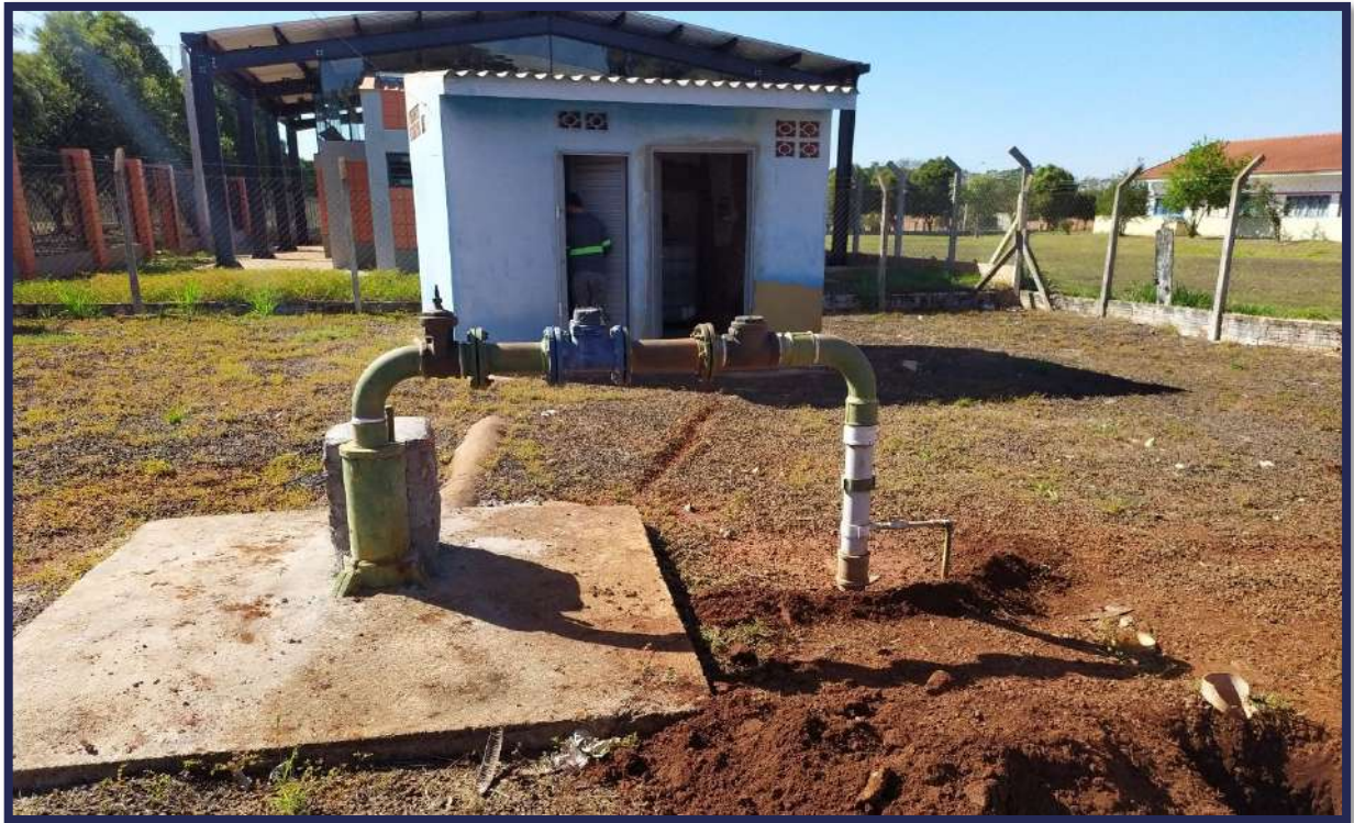
Figura 3-17 - Vista atual das instalaes do Poo 10.
