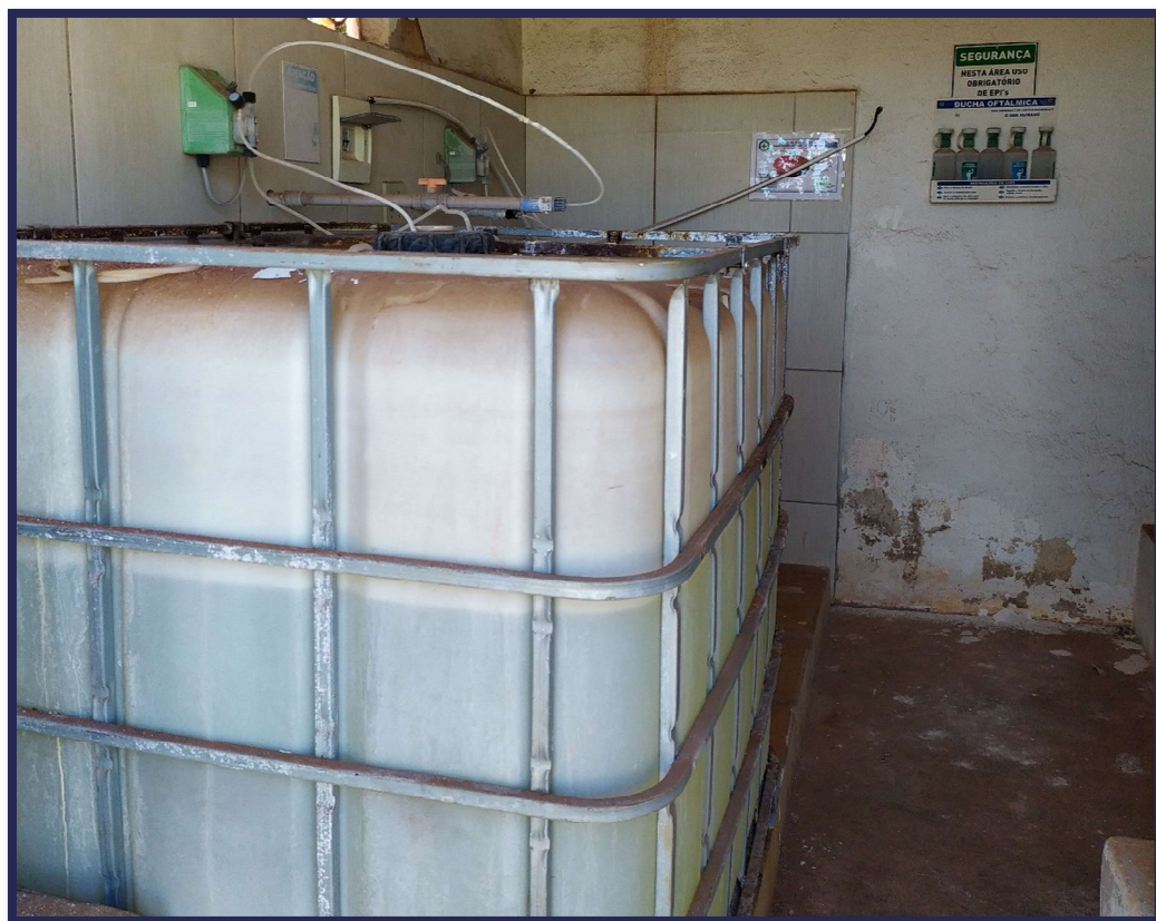
Figura 3-15 - Vista atual das instalaes do Poo 08.
