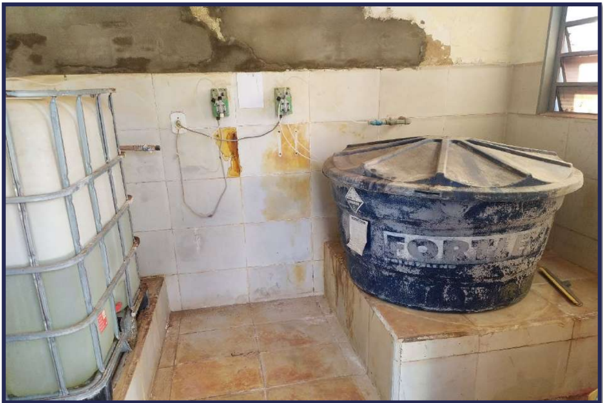
Figura 3-24 - Vista atual das instalaes do Poo 06.
