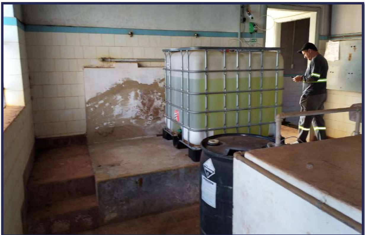
Figura 3-21 - Vista atual das instalaes do Poo 03.
