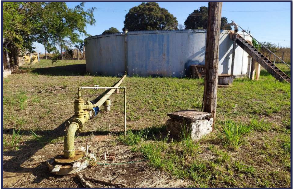
Figura 3-20 - Vista atual das instalaes do Poo 03.
