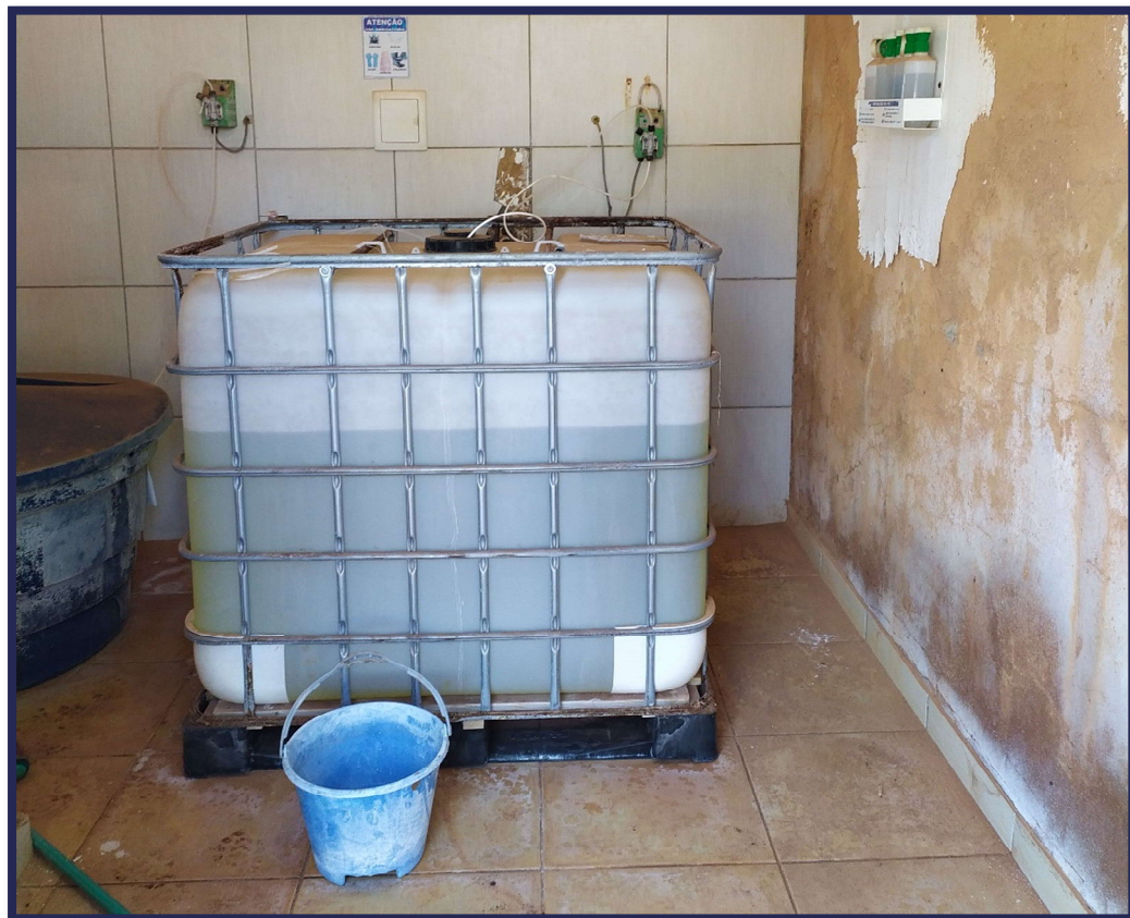
Figura 3-18 - Vista atual das instalaes do Poo 10.
