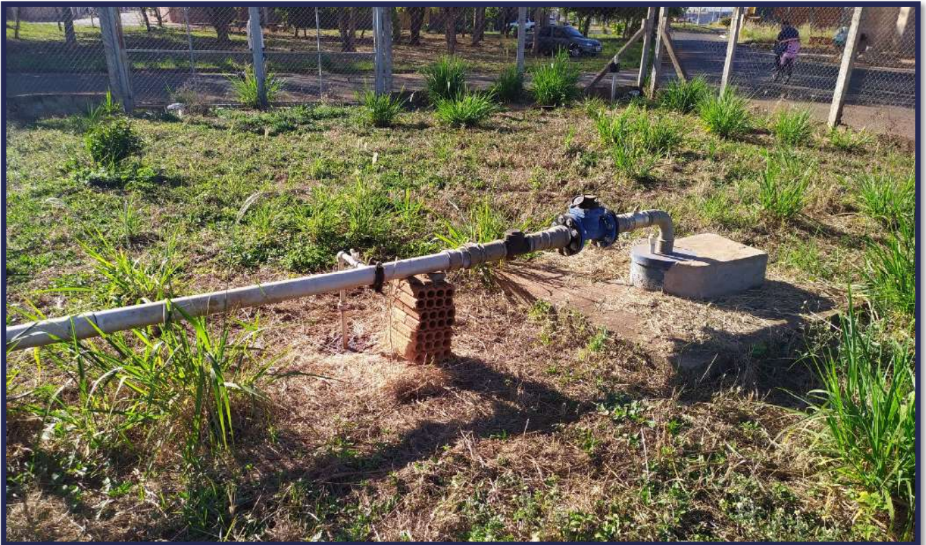
Figura 3-29 - - Vista atual das instalaes do Poo 12.
