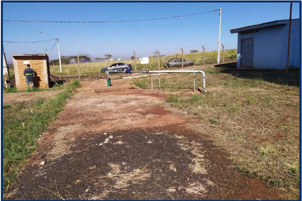
Figura 3-11 - Vista atual das instalaes do Poo 11.
