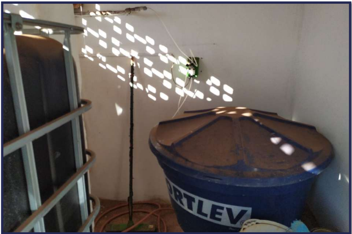
Figura 3-27 - Vista atual das instalaes do Poo 09.
